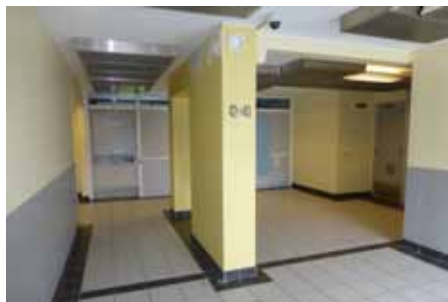
I lavhusenes stueetager er der et stort foyer-område, som ikke virker imødekommende. Som udgangspunkt var der gennemgang i foyeren men flere steder er der indrettet boliger i den del, der er modsat gårdsiden.
